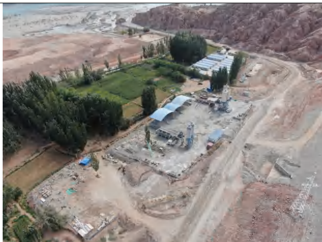
2 标-水电十一局施工生产生活区 (E76°35'30.49", N37°55'12.13")
